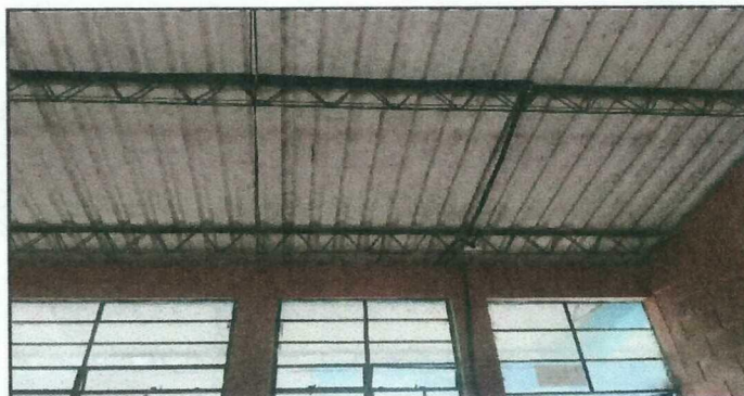
FOTOGRAFIA 4: SE NECESITA LA PINTURA DE ESTRUCTURA DE TECHO YA QUE ACTUALMENTE TIENE CORROSION Y HAY RIESGO DE QUE DAÑE LAS LAMINAS DE LA ESCUELA.
