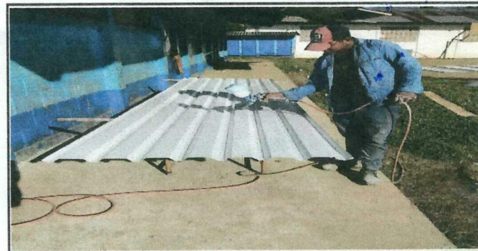
FOTOGRAFIA 6: SE PREVEE LA PINTURA GENERAL DE LA ESCUELA YA QUE SE ENCUENTRE EN MAL ESTADO, EN TOTAL SE NECESITA PINTRA 4 MODULOS COMPLETOS
