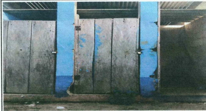
FOTOGRAFIA 2: SE NECESITA CAMBIAR PUERTAS NUEVAS DE METAL PARA REEMPLAZAR LAS DE MADERA QUE SE ENCUENTRAN ACTUALMENTE INSTALADAS.
